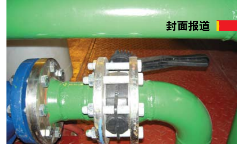
泰科流体控制的Keystone品牌旗下的Composed高耐腐蚀复合阀门装载了压缩机组用于处理冷却水
