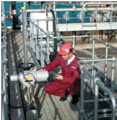
Dardowei 污水处理工场的 IQ2 执行器非侵入式调试。
