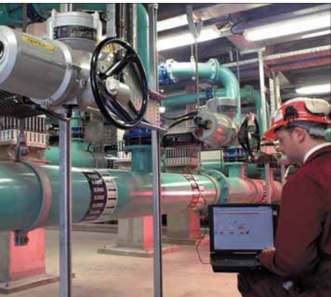
在苏格兰，Rotork 电子执行器应用于新建的废物处理工场。
